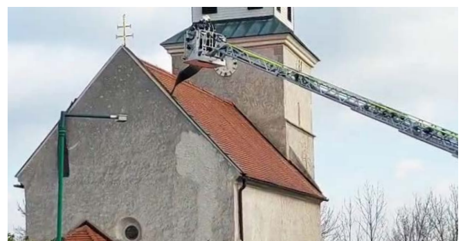
Der Sturmschaden am Kirchendach wurde gesichert.
